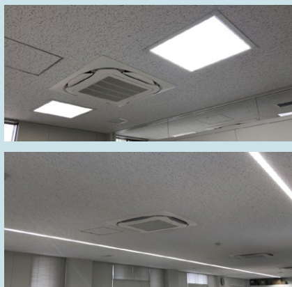
図1 DALIシステム導入事例 照明操作はEnOcean無線スイッチ ビルマルチ空調も連動
