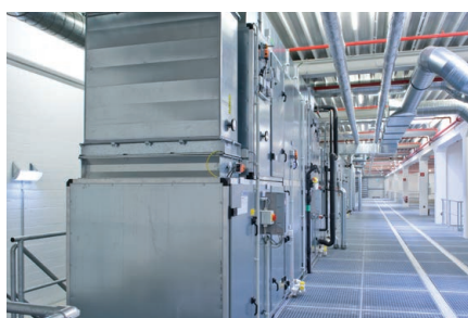
HVAC システム
